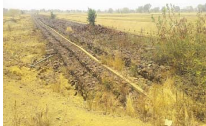
Le déversoir en piteux état.
