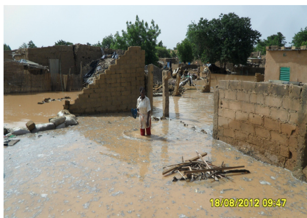
2Planche2: Maisons détruites par les eaux d'inondation à Harobanda, sur la rive droite du Niger
